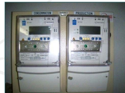
Compteur électrique ERDF
