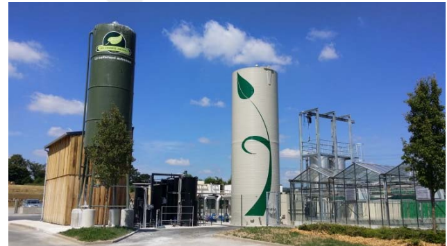
Traitement H 2 S par tour de lavage
