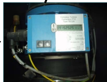
Débitmètre biogaz + correcteur
